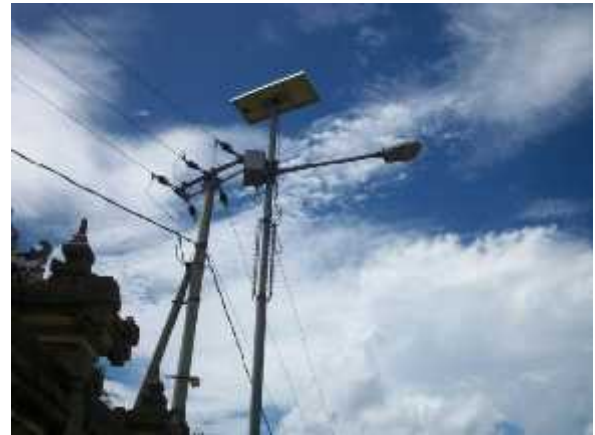
Gambar 4. Penerangan Jalan Umum Tenaga Surya di Pulau Nusa Penida
