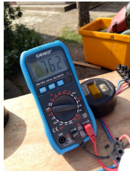
Gambar 12: Penunjukan Hasil pengukuran Tegangan, Arus, Daya pada Generator
