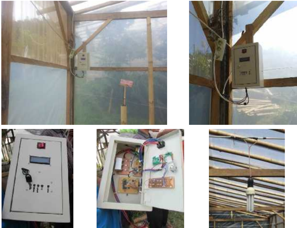
Gambar 2. Instalasi listrik dan alat otomatisasi pencahayaan
